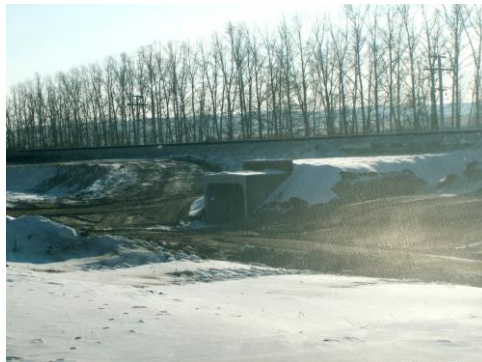
Рис. 1. Удлинение водопропускной трубы при строительстве второго пути на участке Карымская – Забайкальск ЗабЖД
